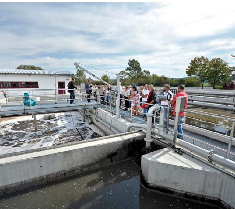
Abb. 12: Probetriebsstart: EssDe Kläranlage-Kiebingen Quelle: Stadtverwaltung Rottenburg
