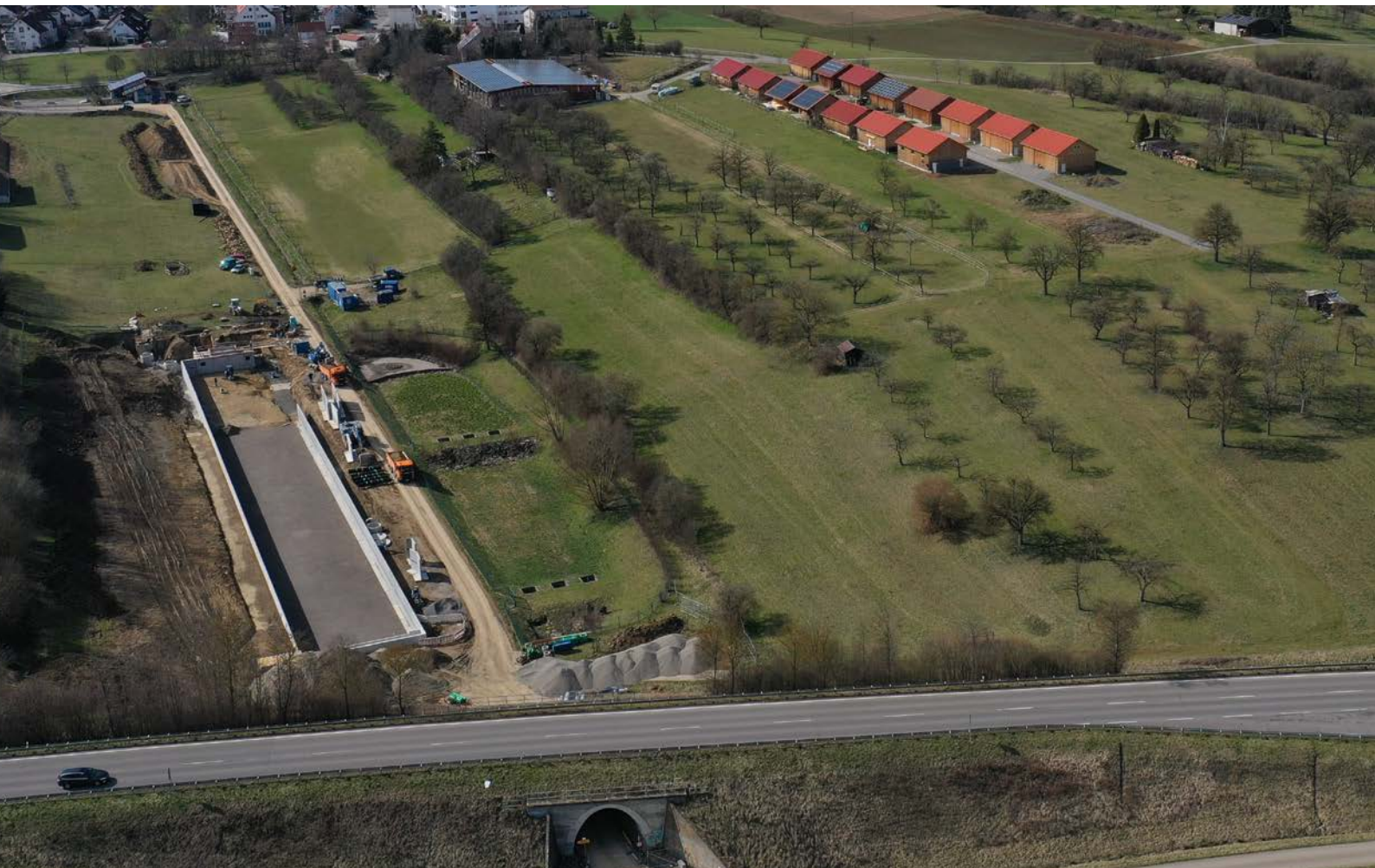
Abb. 14: Neubau Retentionsbodenfilter AZV Bondorf/Hailfingen
