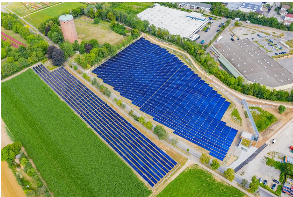
Abb. 35: Solarthermieranlage auf Ludwigsburger und Kornwestheimer Gemarkung (Quelle: SWLB)
