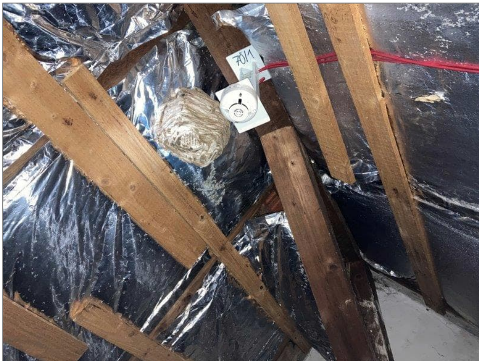
Abb. 12: Dachgeschoss mit Hornissennest (Eberhardstraße 21, Teil FA) (Foto: HPC AG, 04.04.2024)
