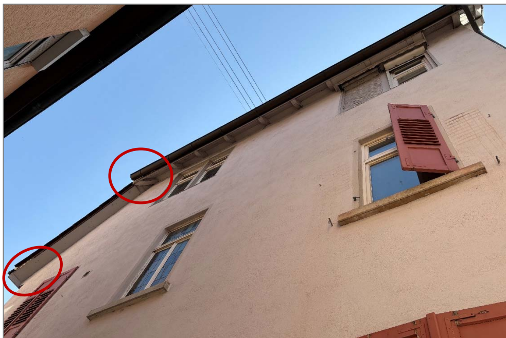
Abb. 2: Mittels Bauschaum verschlossene Einfluglöcher am Bestandsgebäude in der Eberhardtstraße 19 (Quelle: HPC AG, 09.03.2026)
