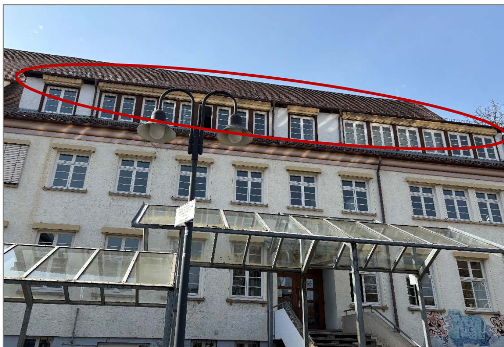
Abb. 4: Durch Holzbretter und Bauschaum verschlossene Nistnischen an der Ostseite des Gebäudes in der Eberhardstraße 21 (Quelle: HPC AG, 09.03.2026)
