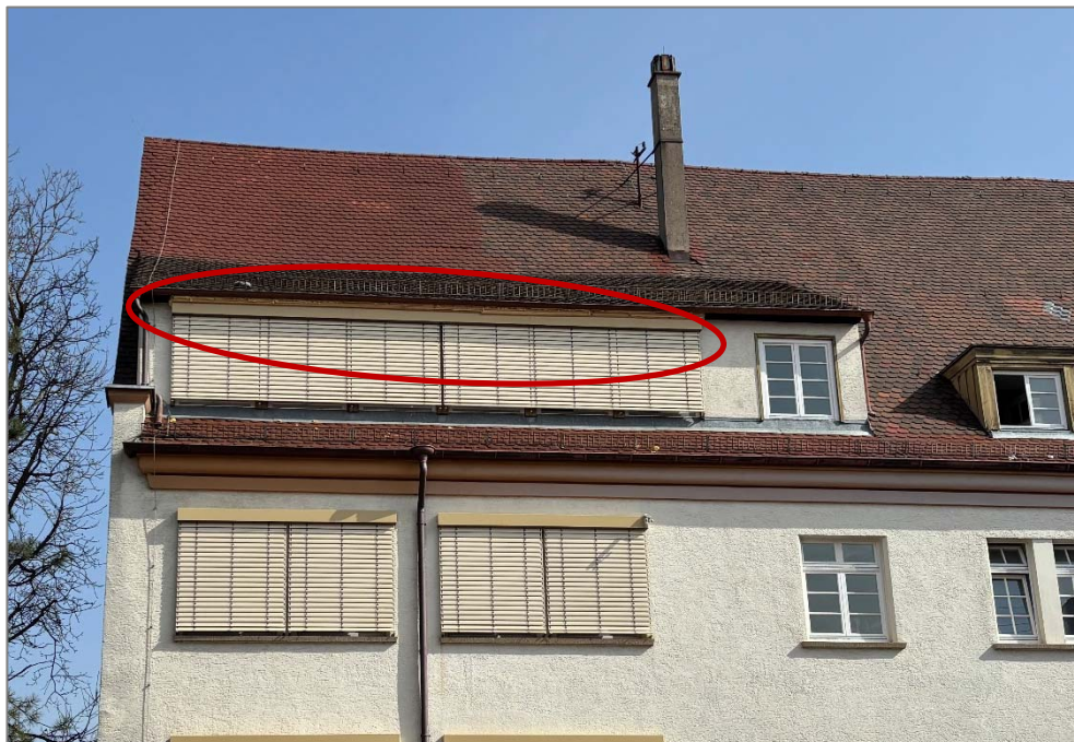
Abb. 3: Durch Holzbretter und Bauschaum verschlossene Nistnischen an der Westseite des Gebäudes in der Eberhardstraße 21 (Quelle: HPC AG, 09.03.2026)
