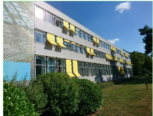
Außenliegender Sonnenschutz an einem Gewerbegebäude (Geo-Net 2023)
